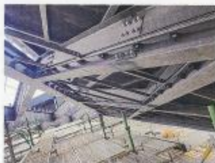
写真3 折れ梁の下フランジ面
